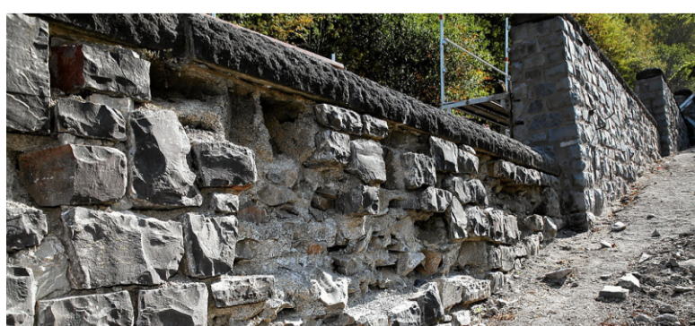
Vor der Sanierung wies das Mauerwerk der Kaskade deutliche Schäden auf. Nach Abschluss der Arbeiten sind die volle hydraulische Leistungsfähigkeit und die Standsicherheit wieder gesichert.
